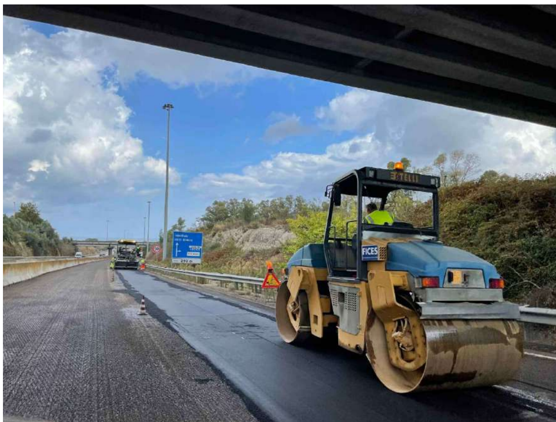
62. Messa in sicurezza e rifacimento sede stradale della Tangenziale Est, 2022 – Lecce (LE)
