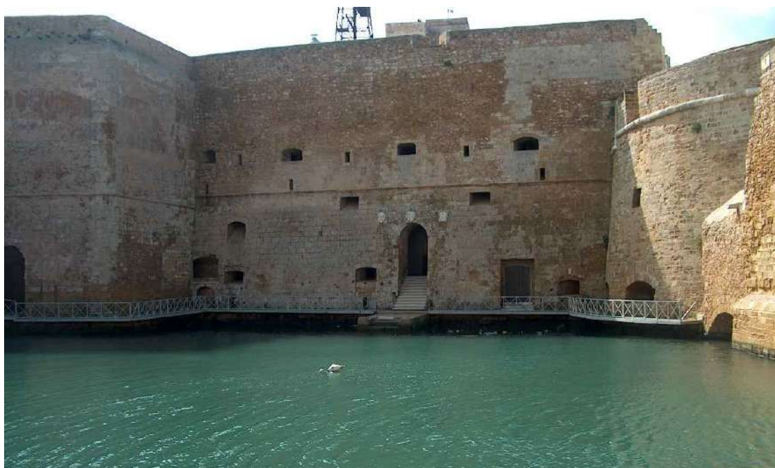
52. Consolidamenti statici delle Mura a mare Castello Alfonsino, 2000 – Forte a Mare Brindisi (BR)
